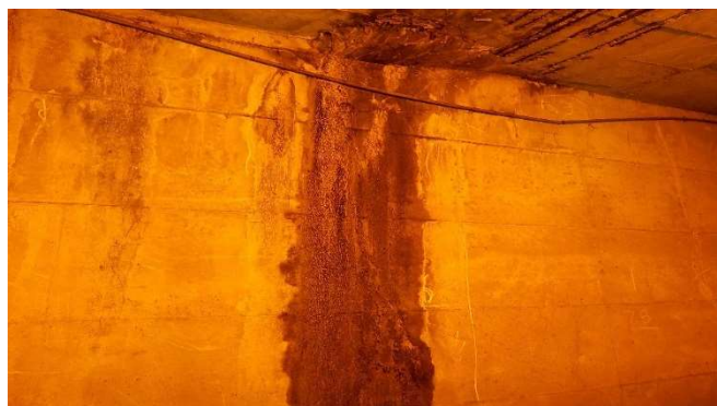
写真 5-1 漏水（トンネル入り口付近左壁）
