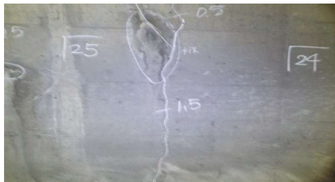
写真 1 ひび割れ（トンネル中央部右壁）
