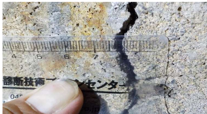
写真 2 ひび割れ（写真 1 の拡大）
