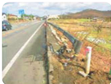
ガードレール・ 標識等の損傷
