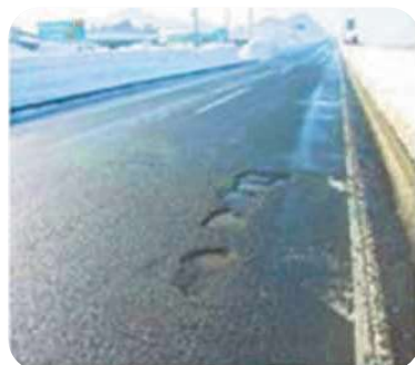
路面の穴ぼこ・ 段差
