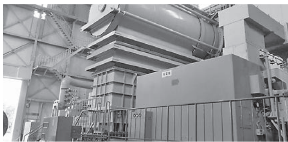
発電機を間近で見学
