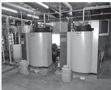
更新されるボイラー
