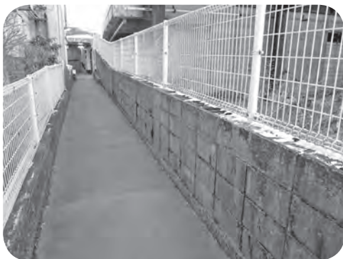
安全が確認されたブロック塀（地下道下側）
