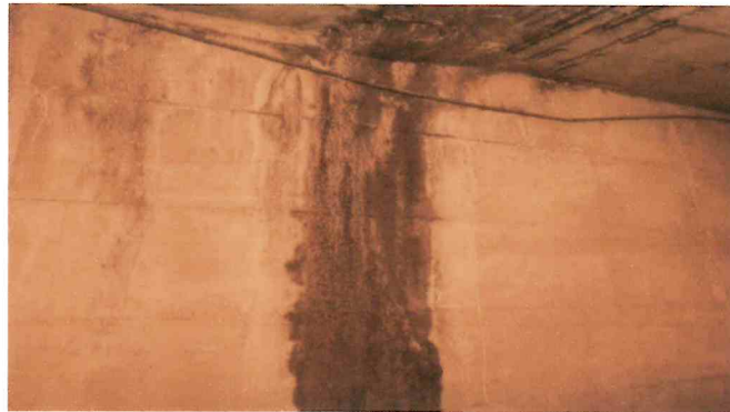
写真 5-1 漏水（トンネル入り口付近左壁）
