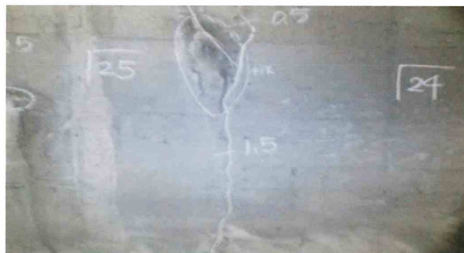
写真 1 ひび割れ（トンネル中央部右壁）
