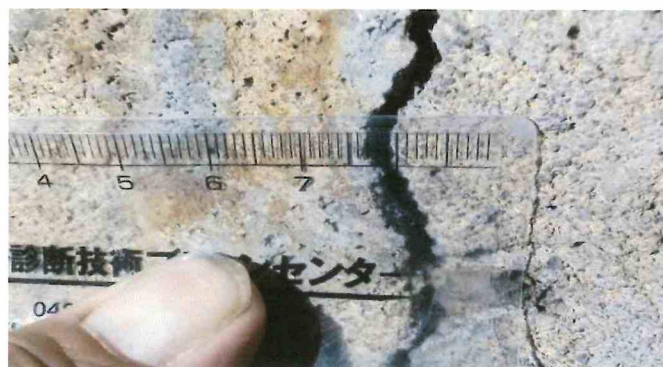
写真 2 ひび割れ（写真 1 の拡大）
