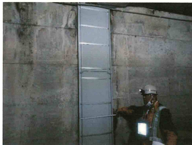
写真 5-1 漏水（トンネル入り口付近左壁）
