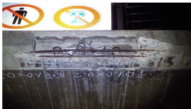
写真 4 剥離による鉄筋露出 (トンネル出口頂版 )
