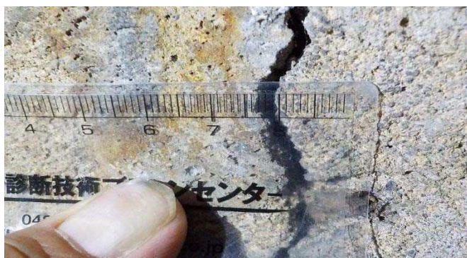
写真 2 ひび割れ（写真 1 の拡大）
