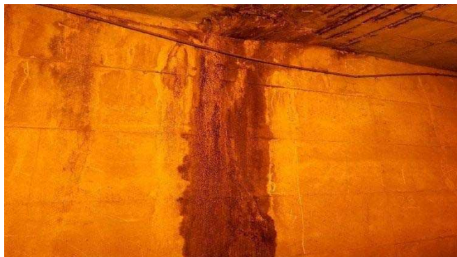
写真 5-1 漏水（トンネル入り口付近左壁）
