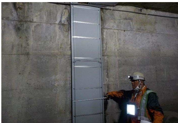
写真 5-1 漏水（トンネル入り口付近左壁）
